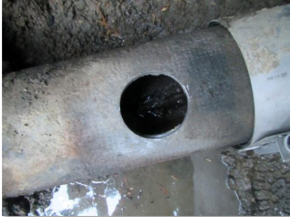
Photo C-9. Pipe coupon hole
